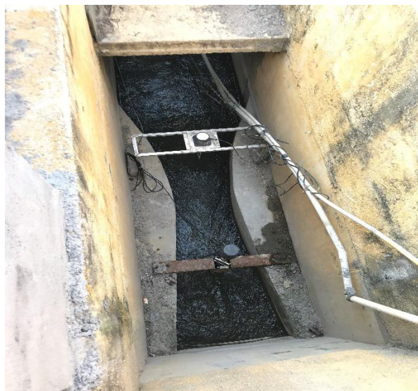
鲁化污水处理厂明渠流量计
