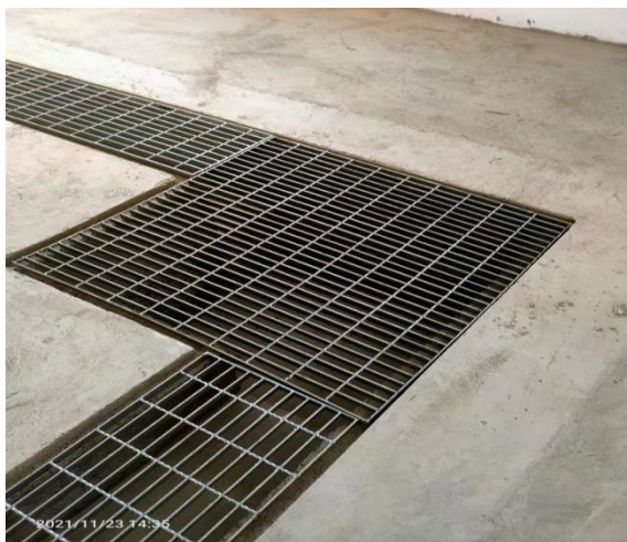
导流沟及收集池
