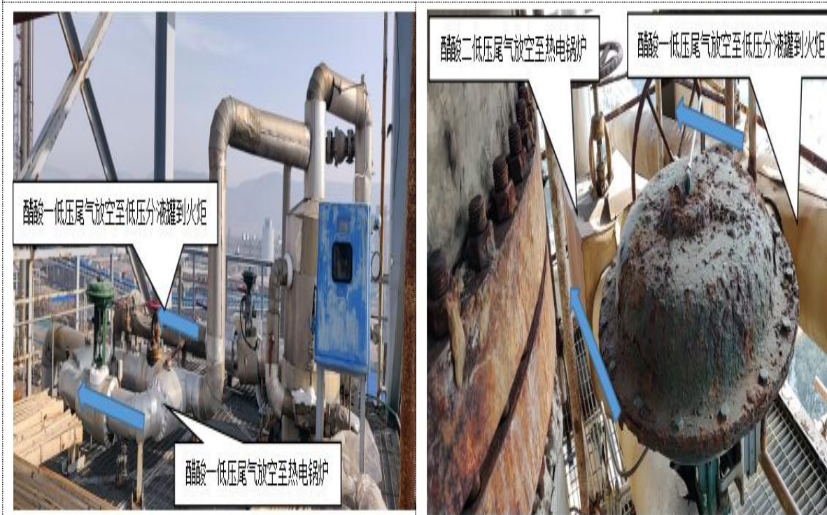
醋酸一装置低压塔尾气至锅炉及火炬
