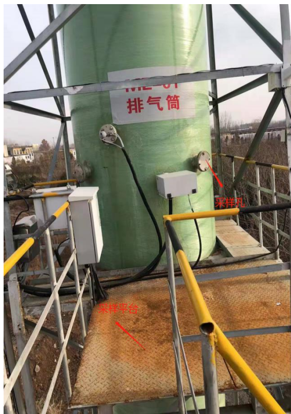
污水处理厂废气排气筒采样孔、采样平台
