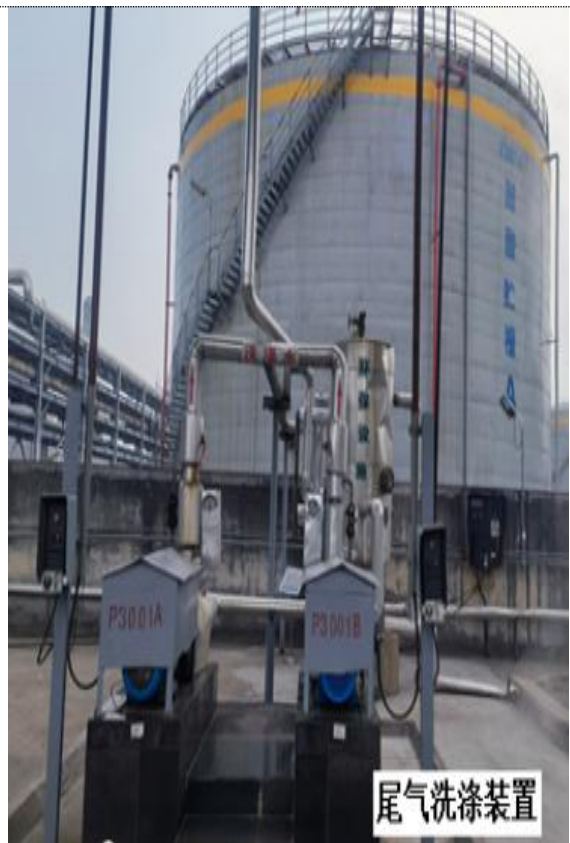
罐区尾气洗涤装置
