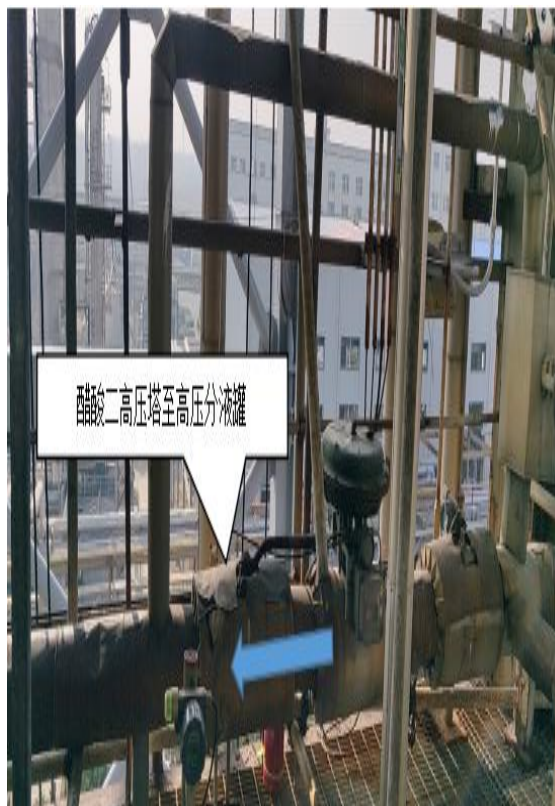
醋酸二装置高压塔尾气至锅炉
