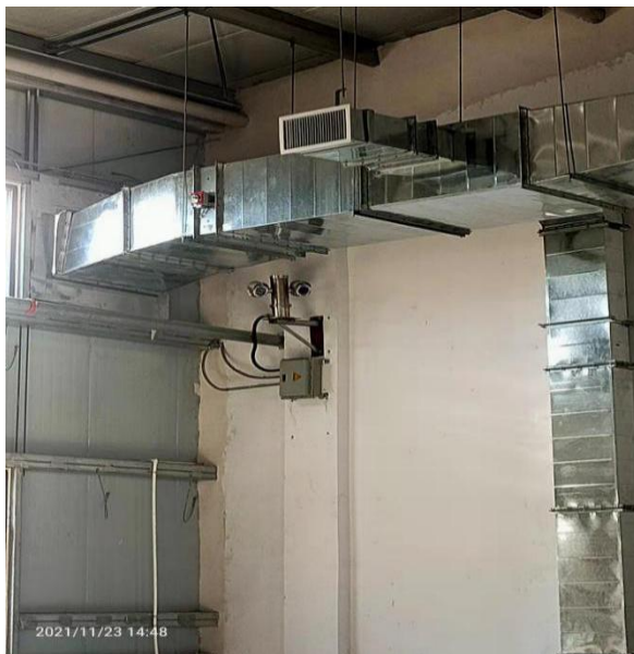
危废间监控设施
