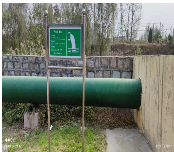
鲁化污水处理厂排污口标识牌
