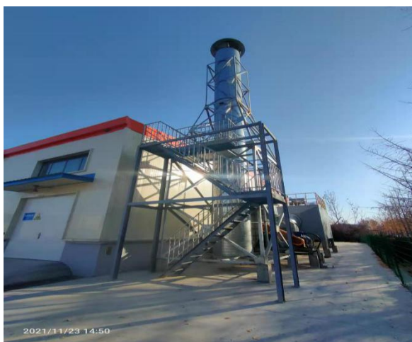
危废间废气处理设施
