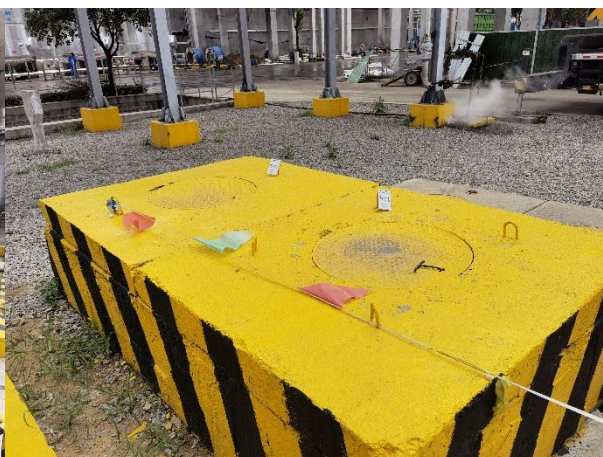
丁醛异构装置初期雨水切换阀
