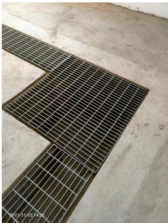
导流沟及收集池
