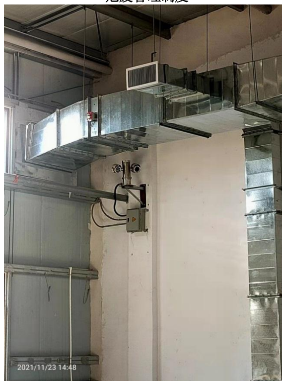
危废暂存间废气收集及监控设施
