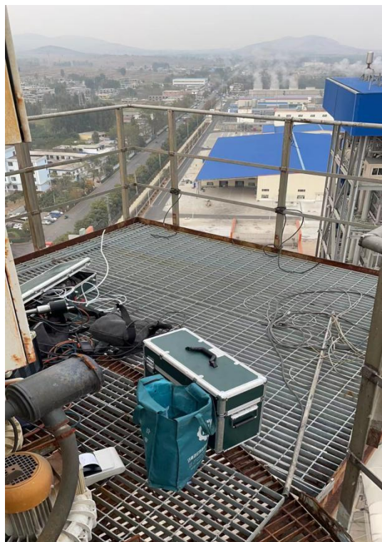
西厂区锅炉排气筒采样平台
