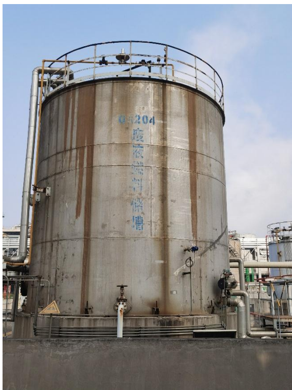
丁醛（醇）装置废液储槽
