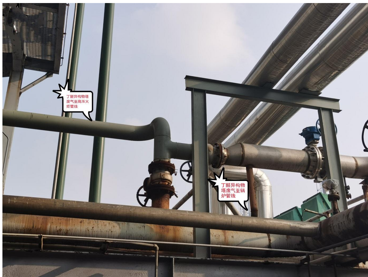
丁醛异构装置废气切换阀及管线
