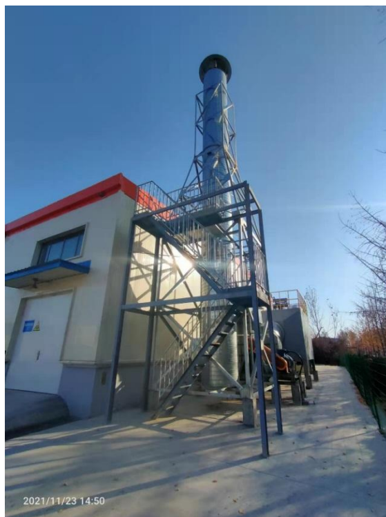
废气处理设施
