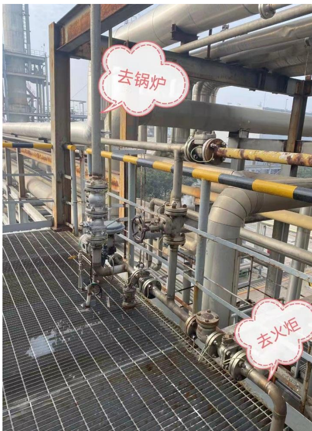
醋酸乙酯装置回收塔废气切换阀及管线
