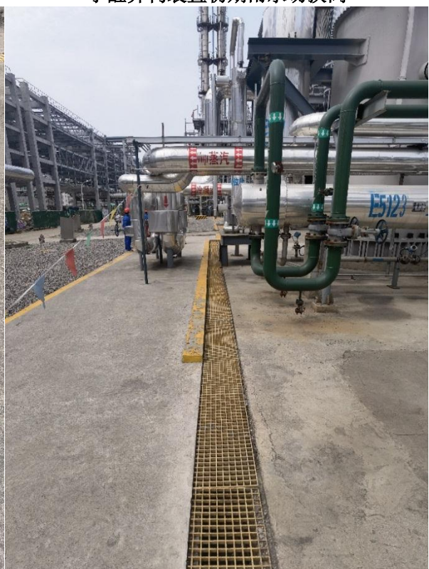
丁醛异构装置区导流渠
