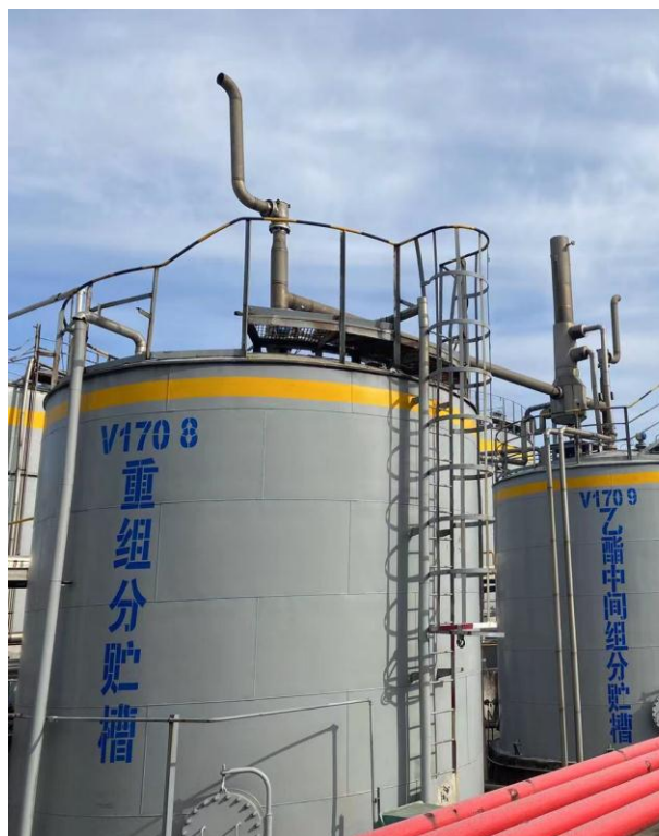
醋酸乙酯装置废液储槽
