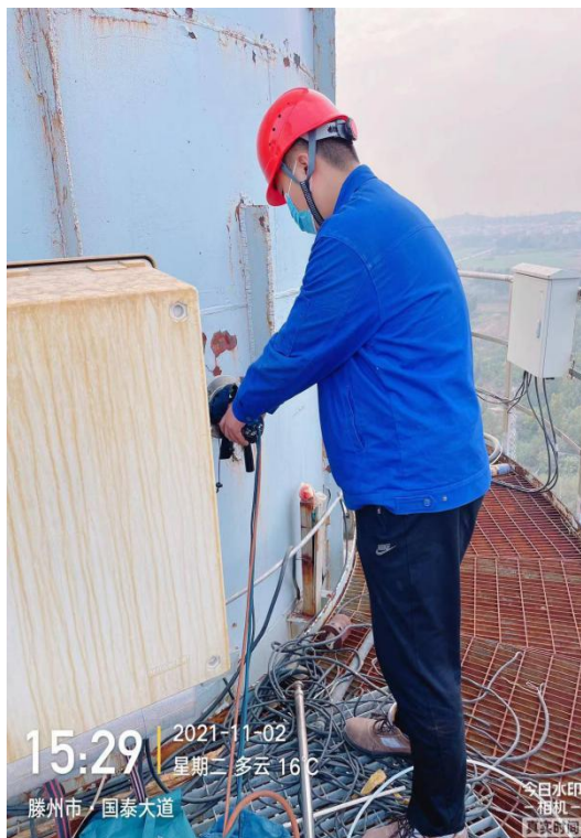
西厂区锅炉排气筒采样口
