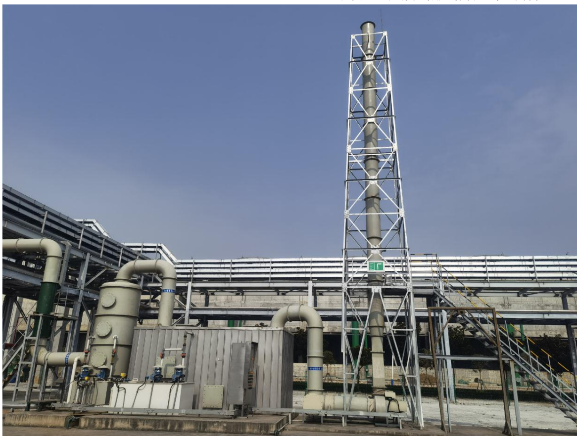
丁醛装置废气收集治理设施及排气筒全景
