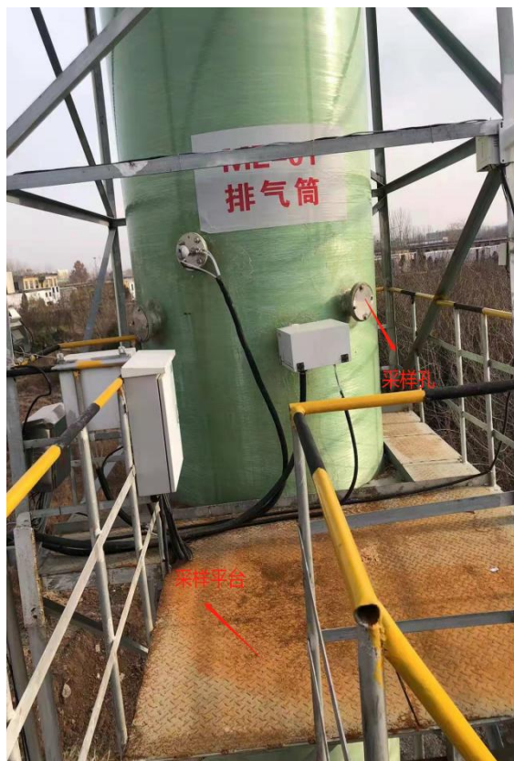
污水处理厂废气排气筒采样孔、采样平台
