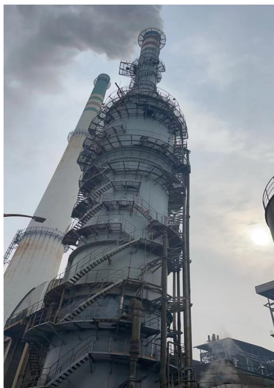
西厂区锅炉排气筒全景
