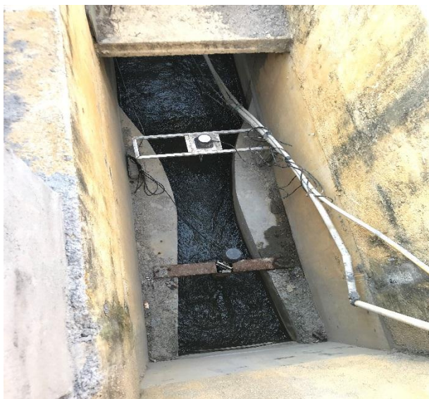
鲁化污水处理厂明渠流量计
