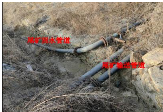
尾矿输送管道、尾矿回水管道
