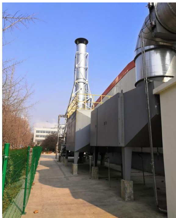
图 4.1-16 废气处理设施
