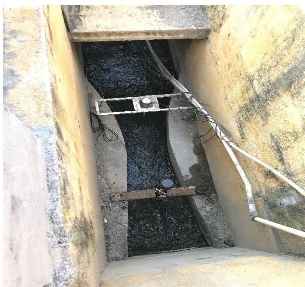
图4.1-6 鲁化污水处理厂明渠流量计
