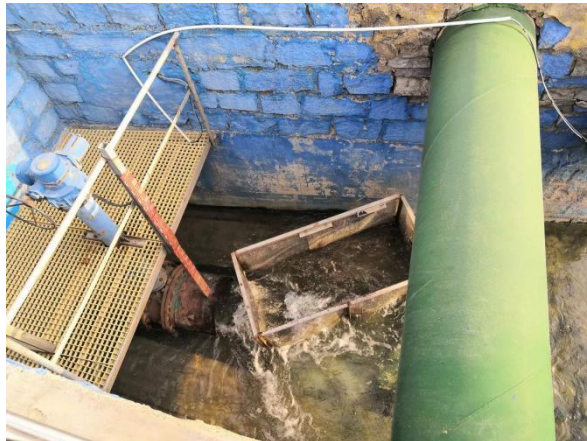
图4.1-8 鲁化污水处理厂排污口
