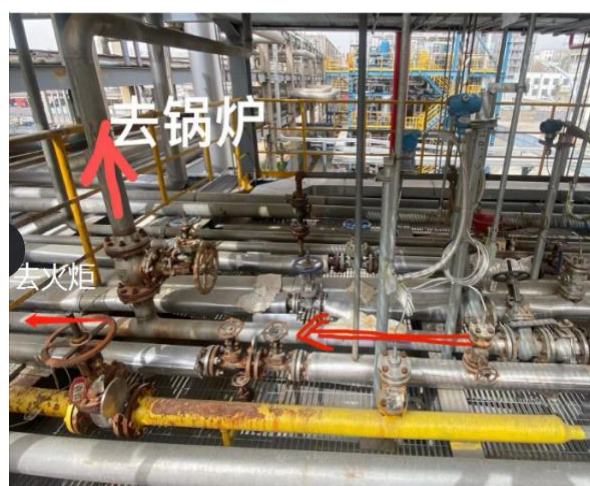
图 4.2-4 醋酐装置区总废气管线及切换阀
