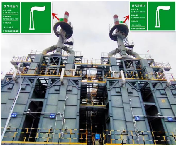
图4.1-2 裂解炉（反应炉）排气筒环保标识
