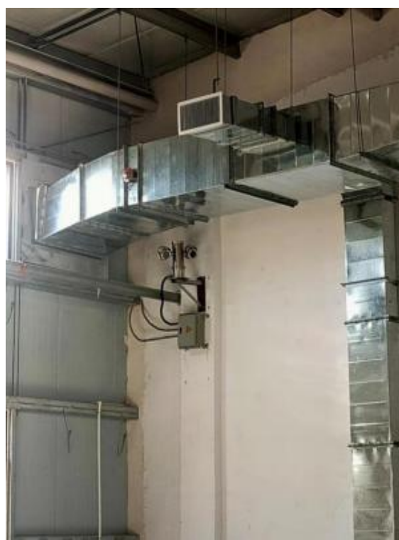
图 4.1-14 危废暂存间废气收集及监控设施
