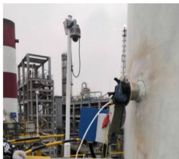
图4.1-5 裂解炉（反应炉）排气筒监测孔
