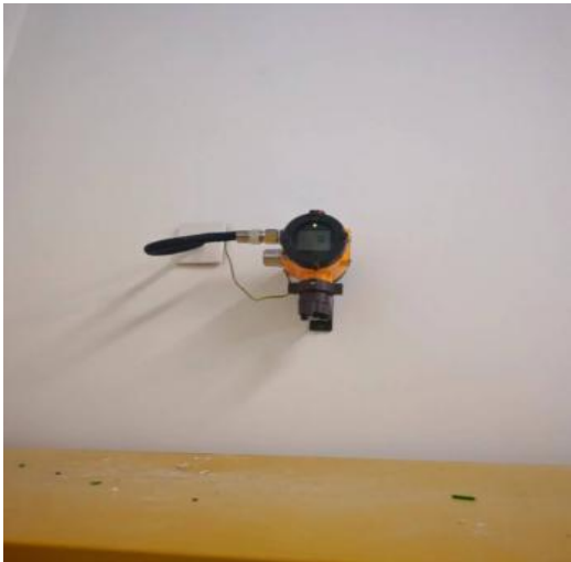
图 3-13 危废暂存间 VOC 浓度检测探头
