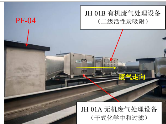
图 3-3 JH-01#处理设施现场图
