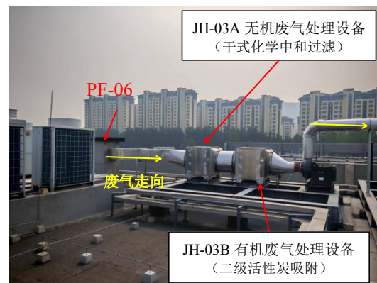
图 3-5 JH-03#处理设施现场图
