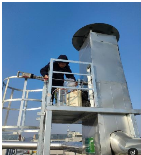
图 6-4 DA015 排气筒排放口监测照片
