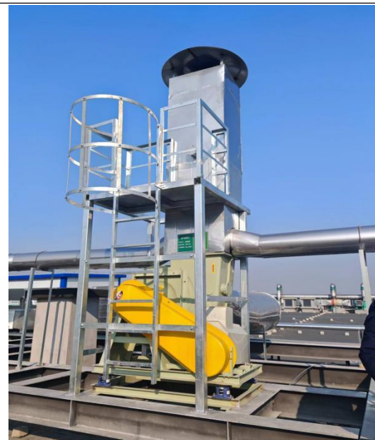
图 3-7 排气筒爬梯、平台、标识等照片
